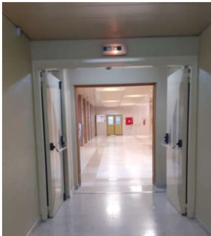
Figura 162 – Porta Corta-Fogo, piso R/C.
