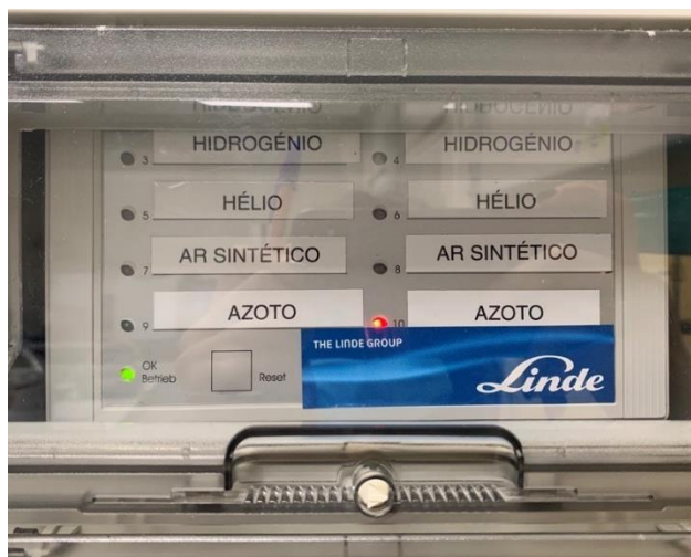
Figura 9 - Painel de monitorização dos gases
