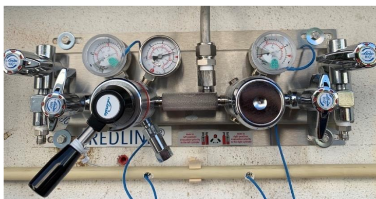
Figura 8 - Exemplo dos manómetros da linha
