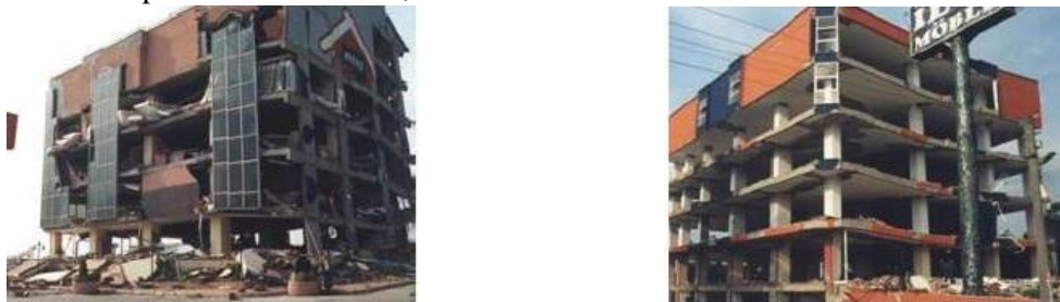
Figura 2.16 – Queda de painéis alvenaria para fora do plano após a rotura devido a ação sísmica (Varum, 2003).
