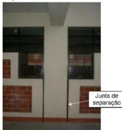
Figura 2.27 – Exemplo de uma folga entre a alvenaria de enchimento e os pilares de betão armado, com bom comportamento face ao sismo ocorrido no Peru em 2001 (Estêvão, 2012).
