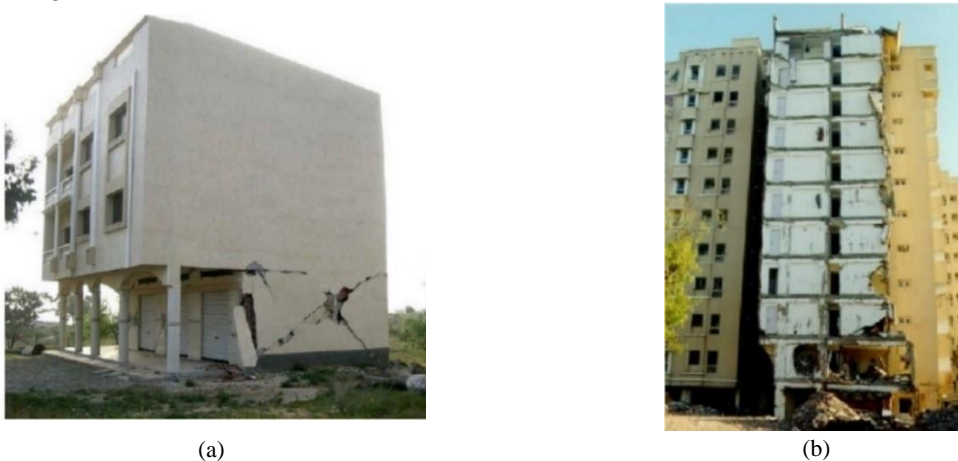
Figura 2.13 – Problemáticas associadas a plantas com distribuições irregulares e muito irregulares: (a) exemplo de danos em edifícios de paredes de alvenaria de enchimento (CORELLA, 2004). (b) colapsos parciais de um edifício (SINHA et al., 2001).
