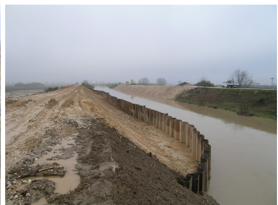
(b) Marginamento costituito dalle palancole.
