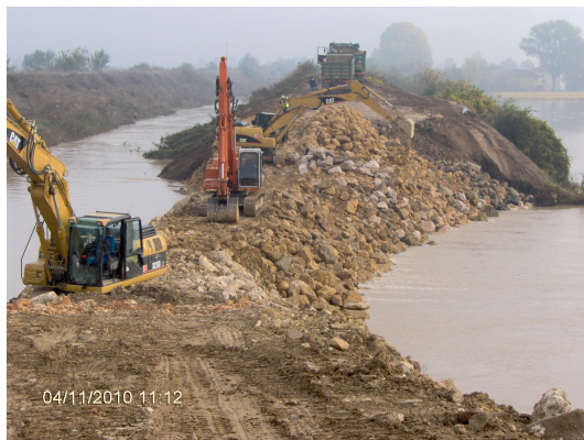
(a) Chiusura della rotta.
