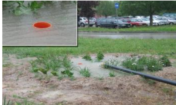
Figura 3. 8: Tubo del troppopieno (Brusaferro, 2012)
