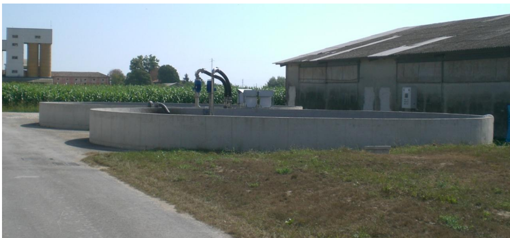
Figura 2.4. Le due vasche di precarico del liquame e del separato liquido
