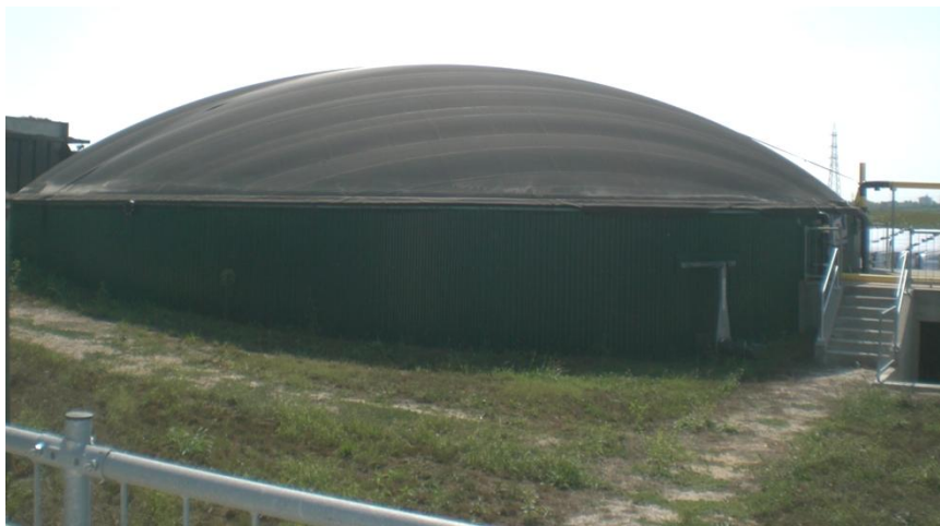
Figura 2.8. Fotografia del biodigestore primario-linea 1. Sulla destra si nota l'accesso alla sala interrata, dove sono alloggiati pompe e strumenti di regolazione del circuito di riscaldamento.
