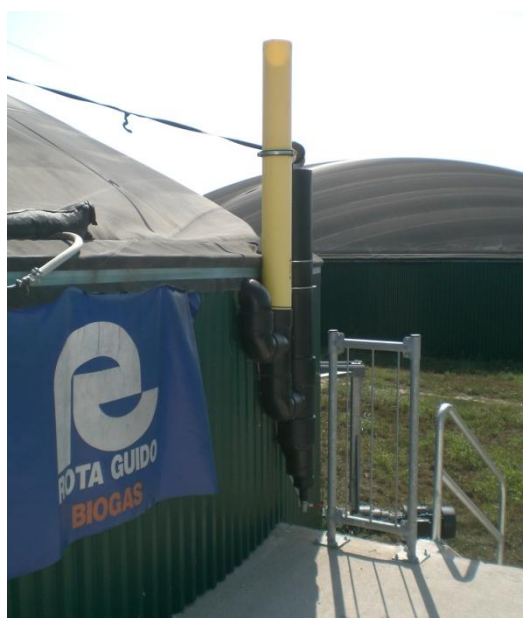
Figura 2.10. Fotografia della guardia idraulica del digestore primario linea 1. Il tubo giallo è il camino per il rilascio in atmosfera del biogas.
