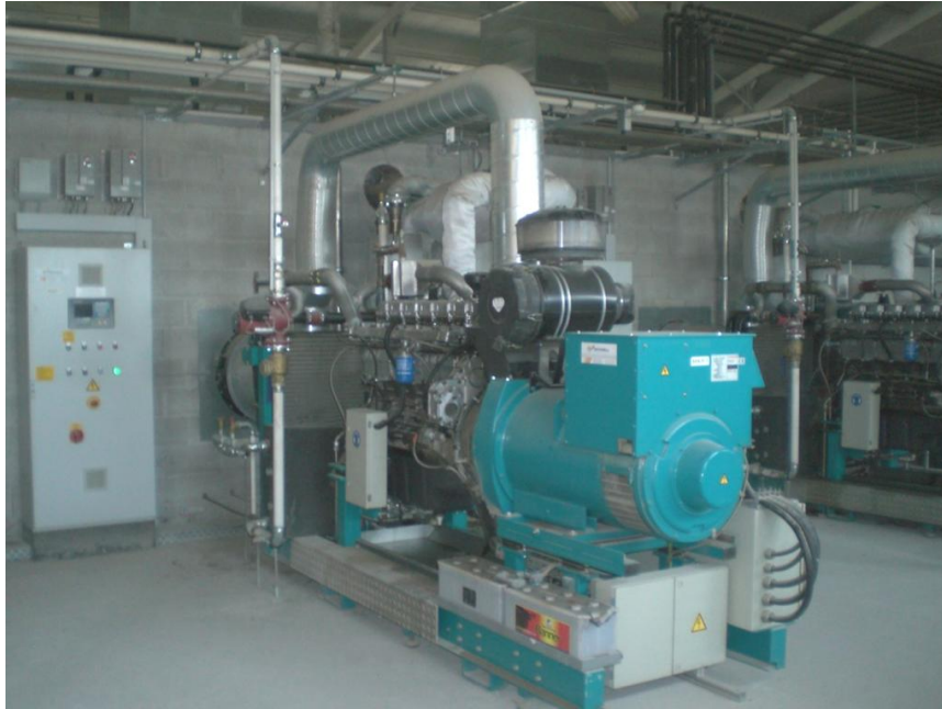
Figura 2.18. Fotografia del terzo cogeneratore. La parte azzurra è la turbina per la produzione di corrente elettrica.
