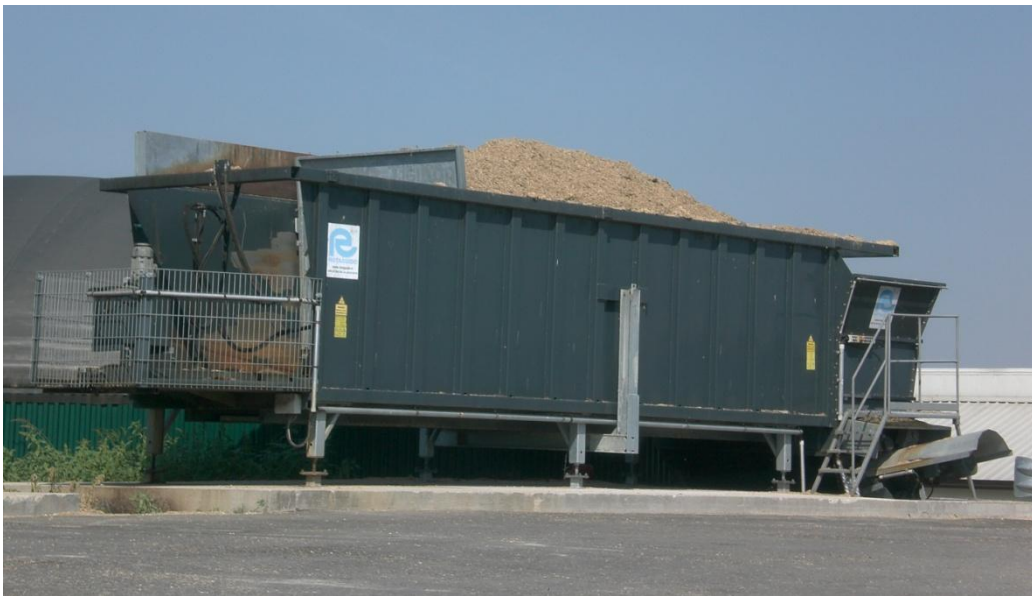
Figura 2.6. Fotografia del modulo di alimentazione solida ( marca Vielfraß ) della linea 1; sulla sinistra si può notare chiaramente la parete compattatrice.
