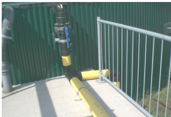
Fotografia 2.12. Snodo di miscelazione biogas linea 1. Il tubo proveniente dal primo digestore incontra l'uscita del biogas del secondo: una valvola (manopola azzurra) consente di regolare la quantità di gas in ingresso da ciascun digestore.
