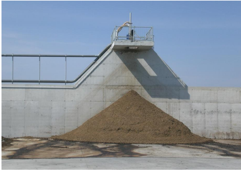
Figura 2.14. Fotografia del separatore e del bacino di accumulo del substrato esausto
