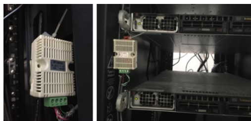
Gambar 9. Instalasi sensor temperature atau Rh SHT20 MD02
