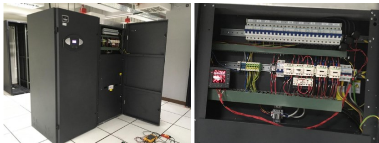
Gambar 11. Pemasangan digital power meter berikut sensor arus ( current transformer ) pada unit Precision Air Conditioner
