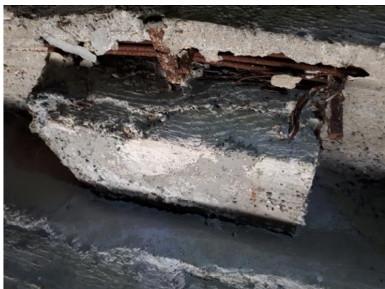
Slika 10. Nedostajući zaštitni sloj betona.
