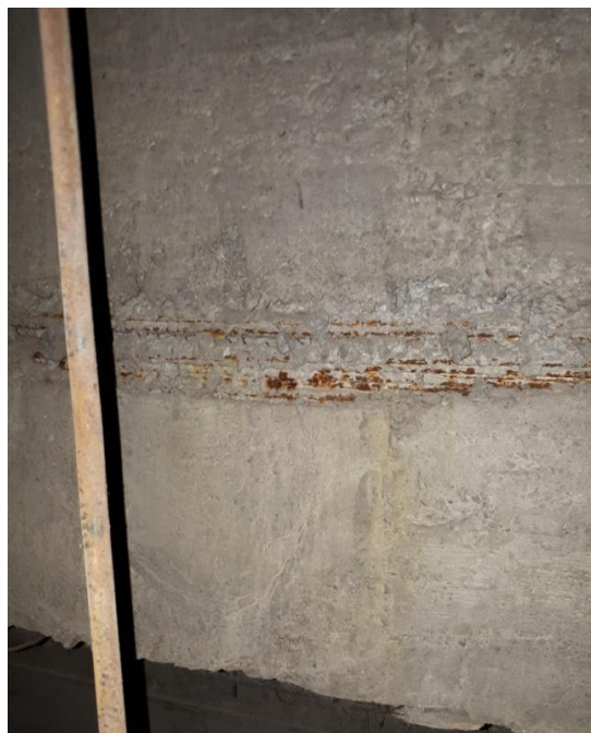
Slika 8. Nedovoljan zaštitni sloj betona do prednapregnutih žica.
