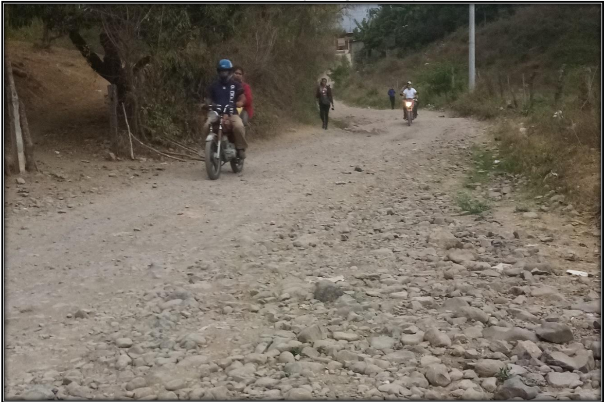
Foto 5. Inexistencia de Drenaje longitudinal (Est. 0+345).
