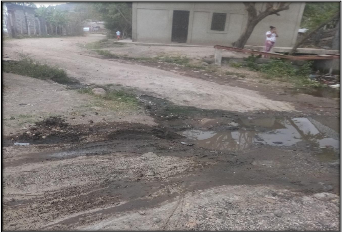
Foto 8. Mal estado de la vía (Est. 0+660).
