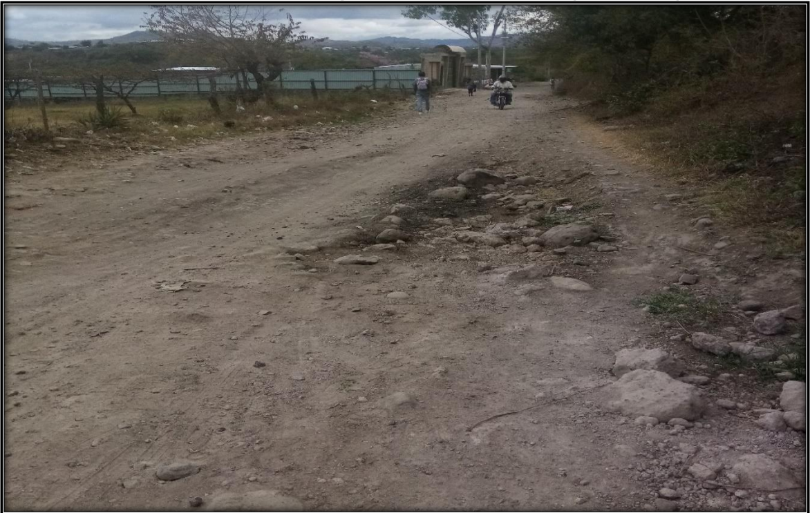
Foto 4. Erosión de la superficie de Rodamiento (Est. 0+318).
