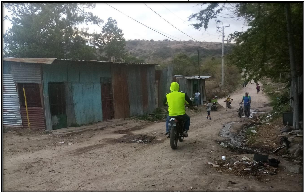
Foto 2. Inexistencia de Cunetas (Est. 0+010).
