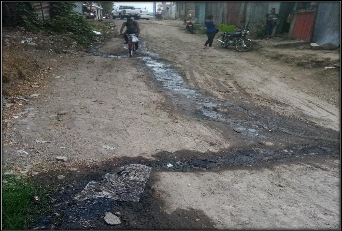
Foto 3. Drenaje Transversal en Mal Estado (Est. 0+045).
