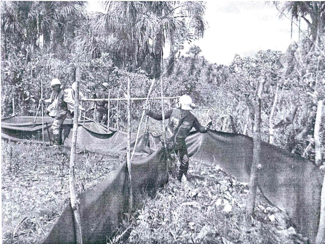
Zona impactada se encuentra protegida con dos barreras de geomembrana, la cual sirve de barrera de contención para que el hidrocarburo no migre a zonas no afectadas.
