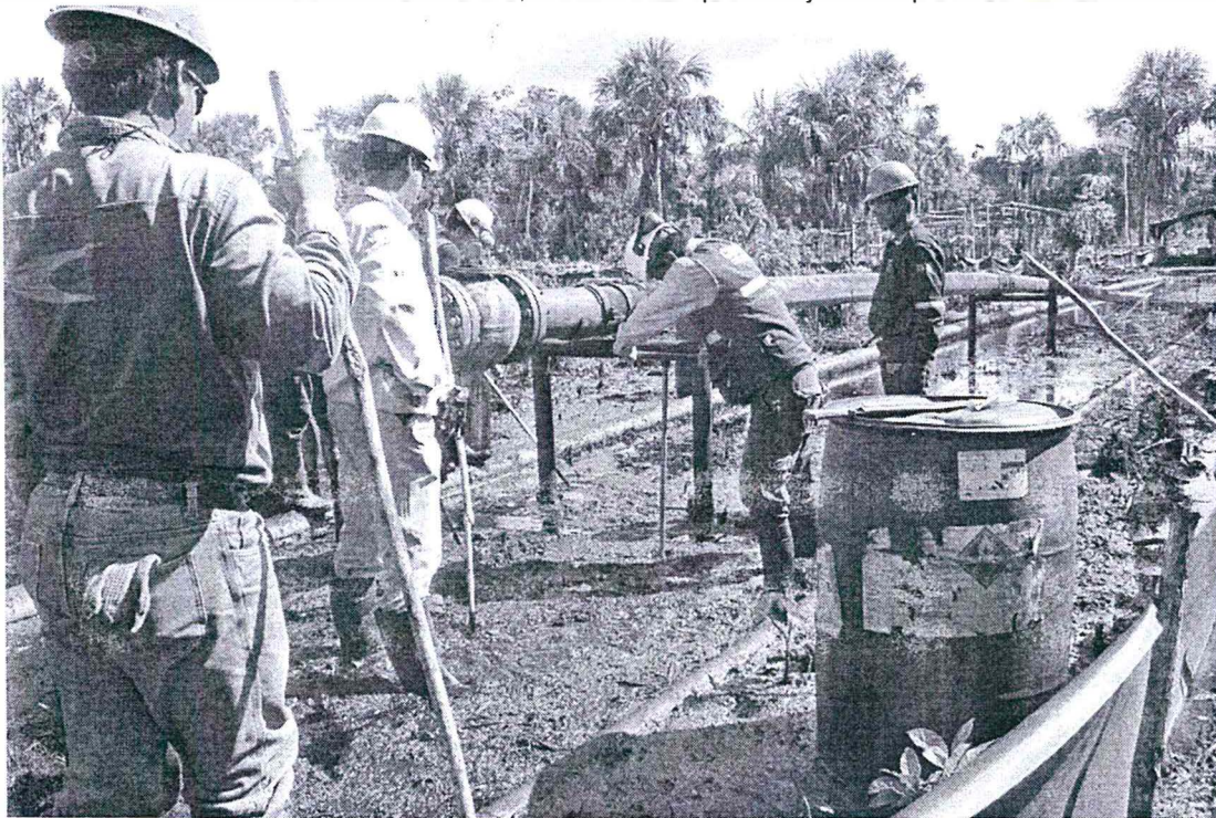
Toma de muestra de suelo dentro del área impactada del incidente ocurrido el 14 de junio el 2013 Km 7+726.
