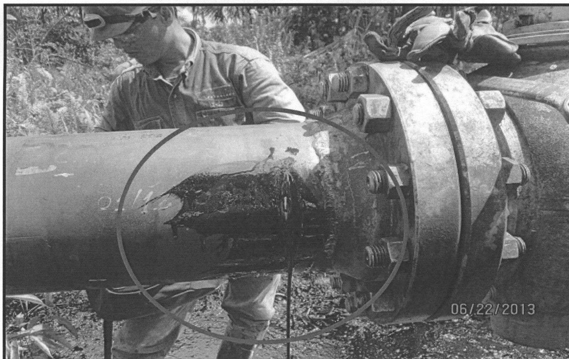
Retiro de las grapas de contención, constatación visual del corte en la tubería.
