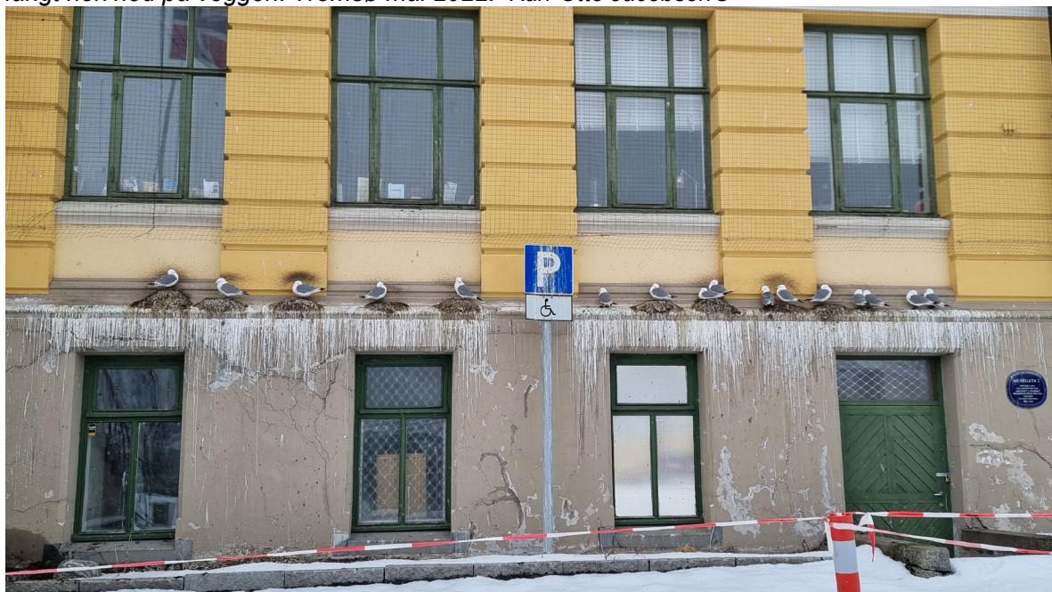
Vedlegg 4. Eksempel på hvor netting er montert på en fasade, men hvor den ikke er montert langt nok ned på veggen. Tromsø mai 2022. Karl-Otto Jacobsen©
