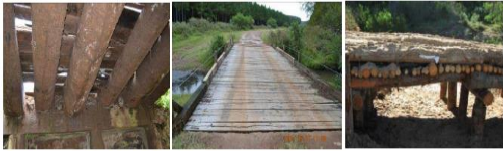
Figura 29: Vigas de madera resueltas con rollizos y entablado de madera Fuente: Proyecto FPTA-306. (Baño, Mazzey, Moya, & Dieste, 2018)
