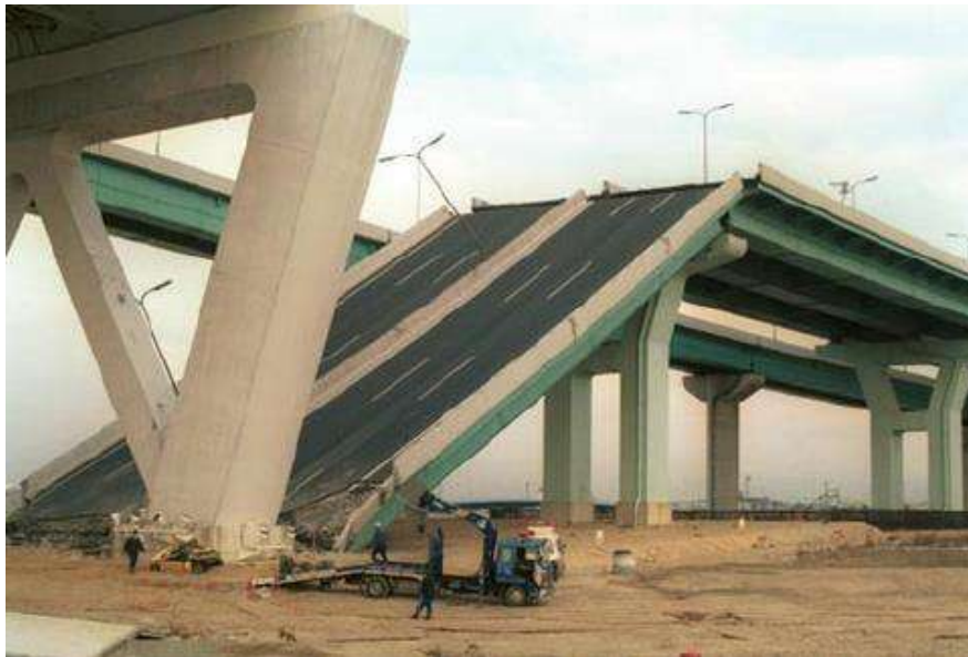
Figura 2.25 Desplazamiento lateral en el puente Nishinomiya, terremoto de Kobe (1995)
