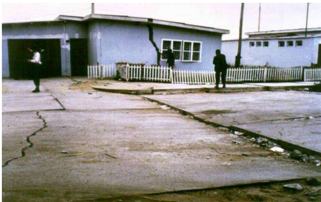
Figura 2.13 Compactación diferencial y deslizamiento lateral en Chimbote 1970
