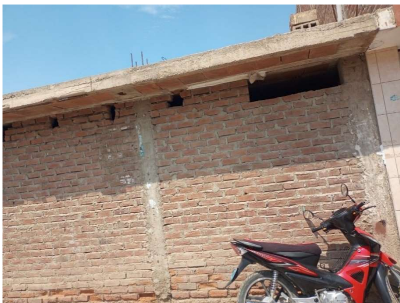
Figura 5.3-4 Edificación, situada en la calle Francisco Carhuajulca cuadra III, manzana 43 lote 5, con deficiencia en la conexión Diafragma – muro.
