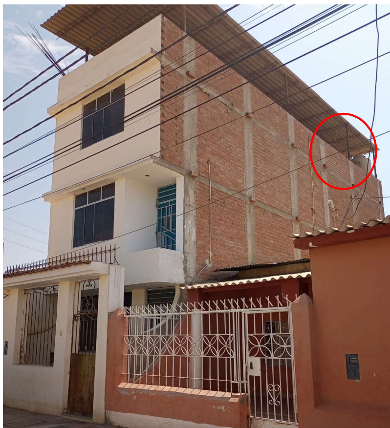
Figura 5.3-8 Edificación, situado en la calle progreso, Sector 02, manzana 12 lote 04, con tanque prefabricado una mala unión al sistema principal de la estructura.
