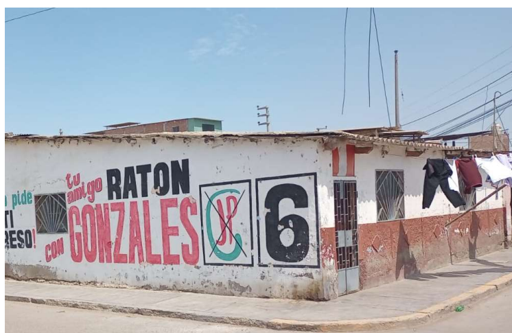
Figura 5.3-3 Edificación, situada en calle Francisco Carhuajulca cuadra VIII, Sector 01, manzana 37 lote 08, se observa sales y humedad.
