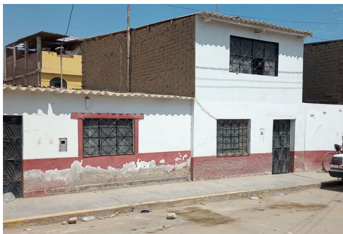
Figura 5.3-5 Edificación de dos niveles, localizada en la calle San Judas Tadeo, manzana 06 lote 11, con detalle de irregularidad.
