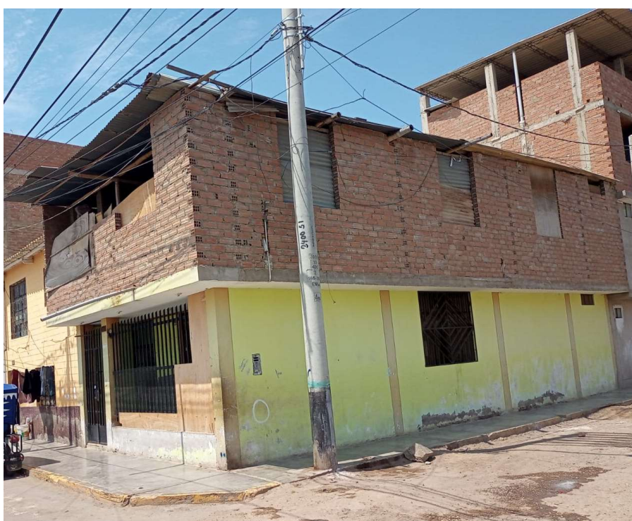
Figura 5. 3-2 Edificación, situada en avenida alto Cayalti, sector 02, manzana 30 lote 17, se observa la mala calidad de materiales, exceso en el espesor de juntas para asentado de ladrillo.
