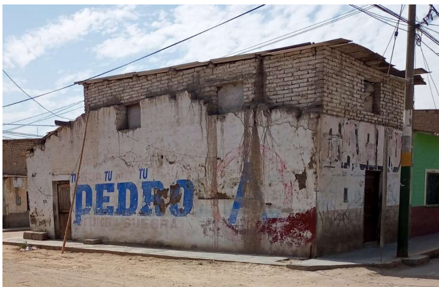
Figura 5. 3-1 Edificación de adobe, localizada en la calle Sáenz Peña, sector 02, manzana 34 lote 01, en la cual se visualiza la falta de confinamiento de los muros en los recodos ni en las longitudes de los muros y tiene cubierta de calamina.
