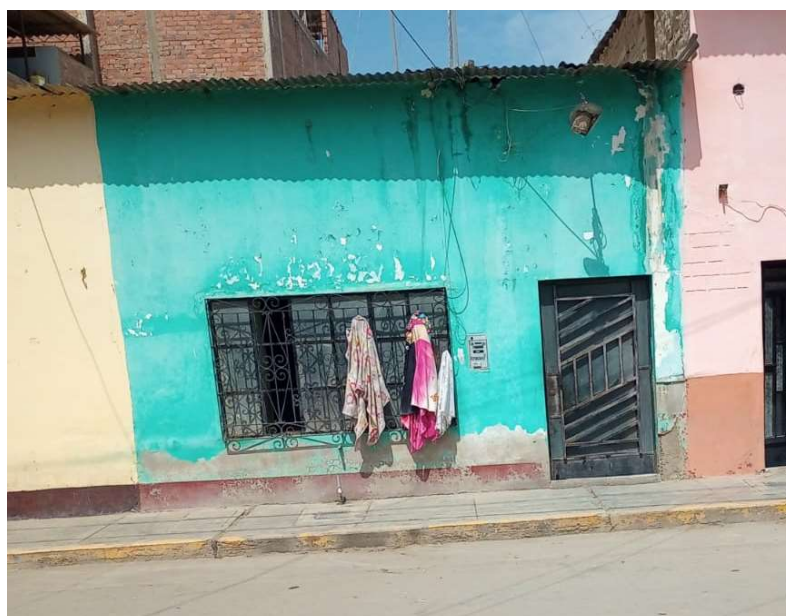
Figura 5.3-7 Edificación, localizada en calle Almirante Grau, sector 02 manzana 12 lote 43, con cubierta de calamina inestable, mala conexión cubierta – Muro de material ligero y en mal estado.
