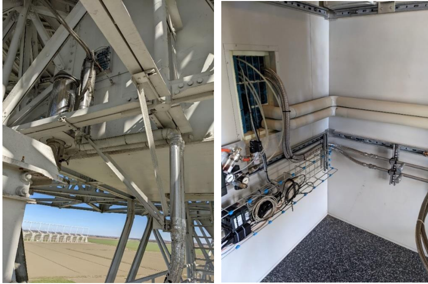
Figura 5 Ingresso tubi e cavi nella V.E.R. Vertex Equipment Room tramite Roxtec
