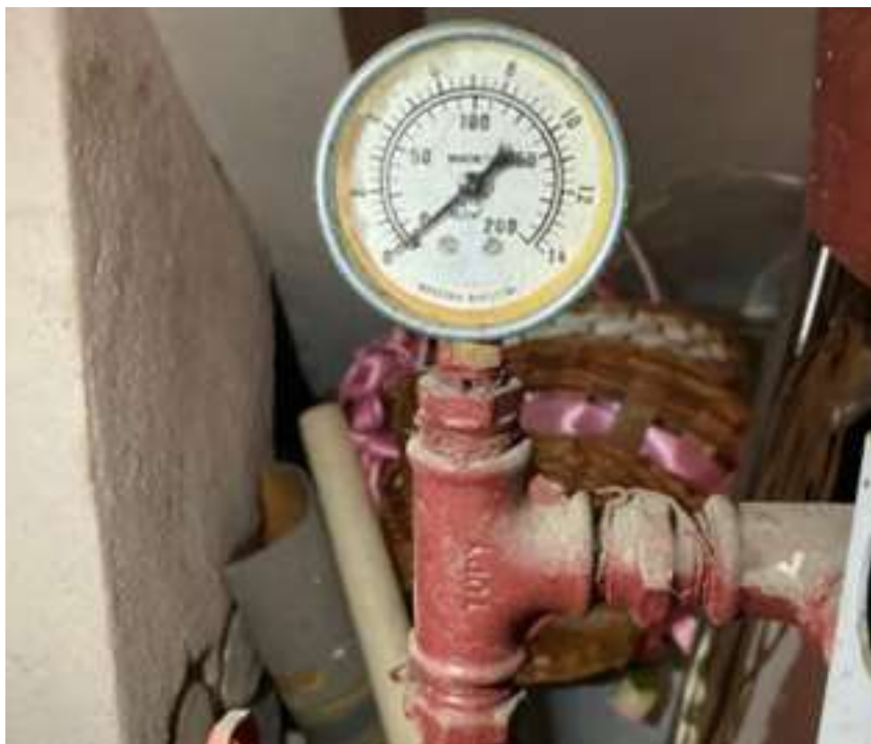
Figura 2 - Manômetro na saída do sistema de combate a incêndio indicando zero MCA
