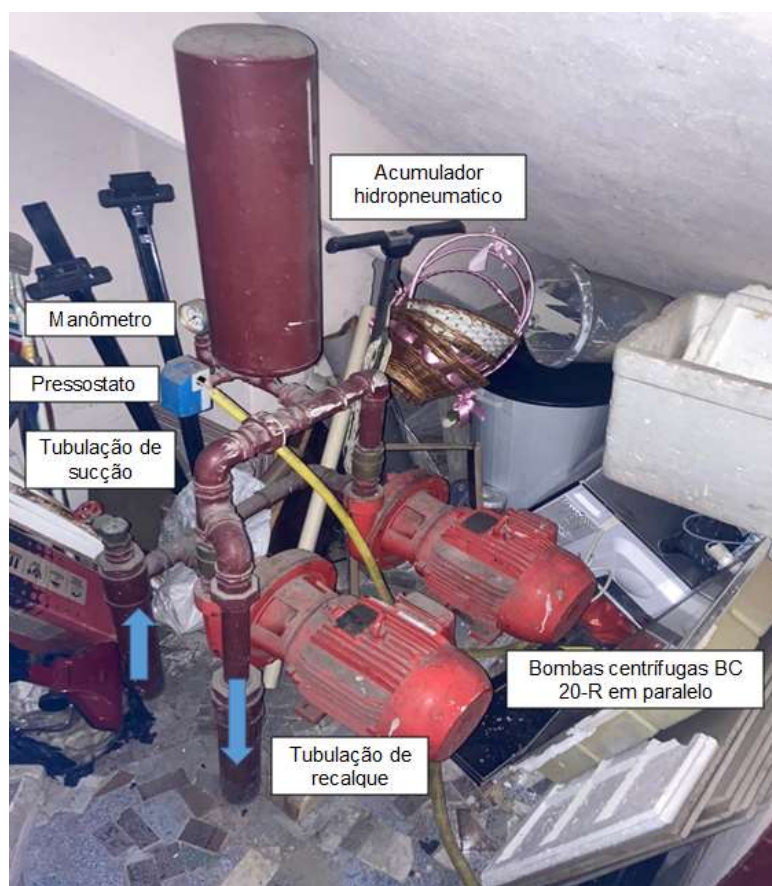
Figura 1 - Sistema de combate a incêndio instalado em prédio residencial
