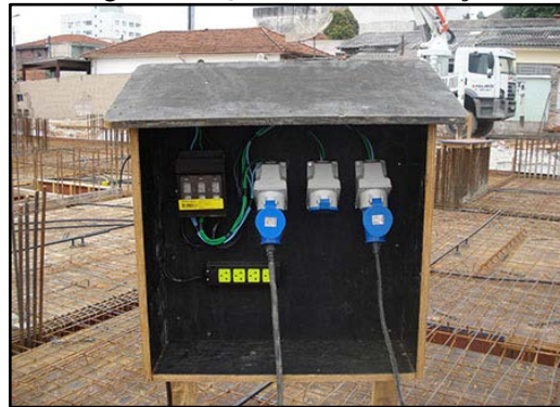
Figura 6 - Quadro de distribuição
