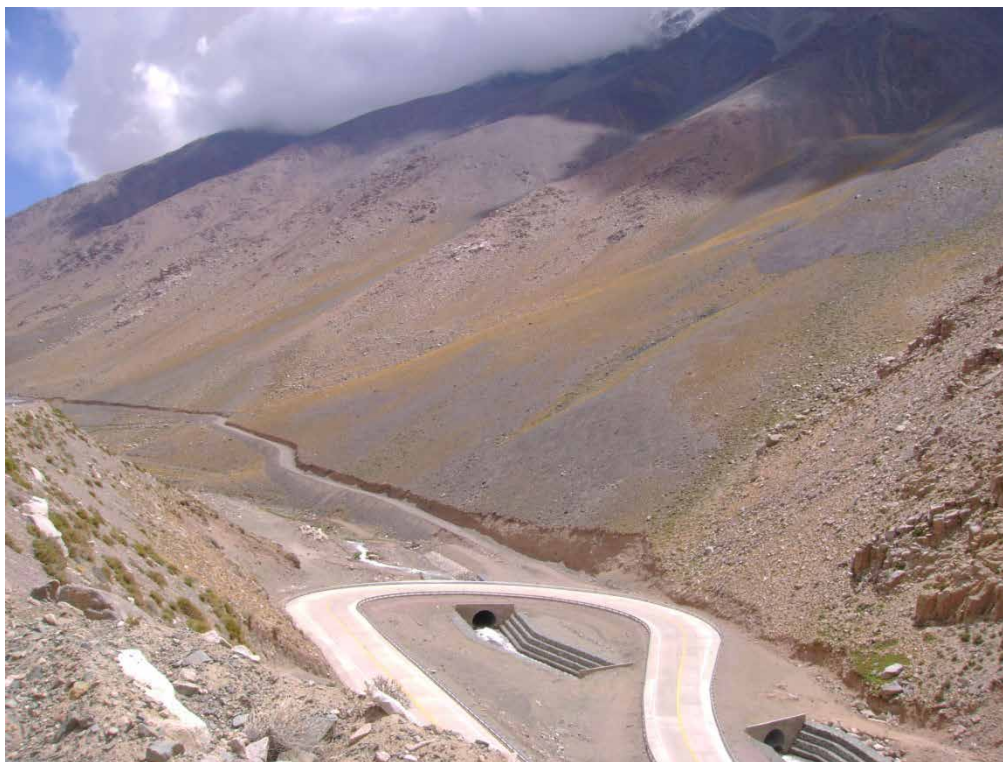
Figura 22. Los cruces de ruta realizados sobre el arroyo del Agua Negra pueden generar endicamientos en el caso de años de importantes nevadas y obstrucción de las alcantarillas por bloques de grandes dimensiones.
