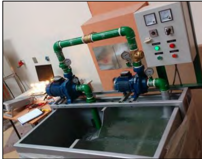
Figura 3: Módulo de Bomba funcionando como Turbina UNA PUNO Fuente: (Quispe & Maquera, 2019, p. 127)
