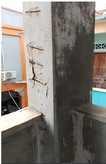
1. Ukuran selimut beton pada sebagian sisi beton tidak memadai
