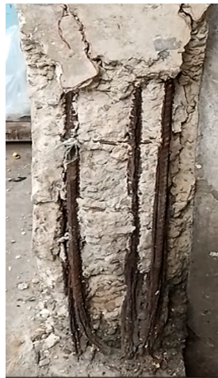
2. Selimut beton terkupas dan tulangan mengalami korosi yang parah
