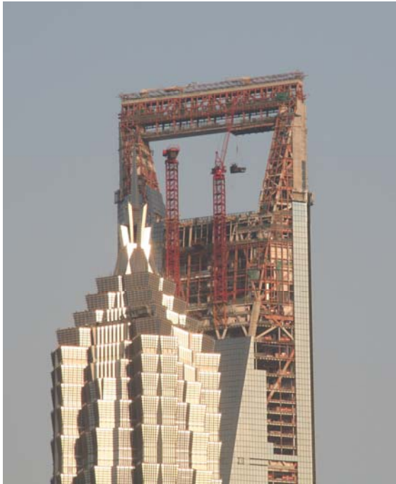
Bild 3: Baustelle an der Spitze des WFC in fast 500 m Höhe (Foto: Horst Werkle)
