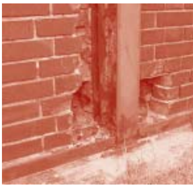
Abb. 10: Korrosionsschaden bei nichtbündiger Ausführung von Stahlprofil und Mauerwerk bei Fachwerk-wänden. [Archiv Dicleli: Zollverein XII, Halle 8: Kompressorenhaus, Aufn. Mai 2002]
