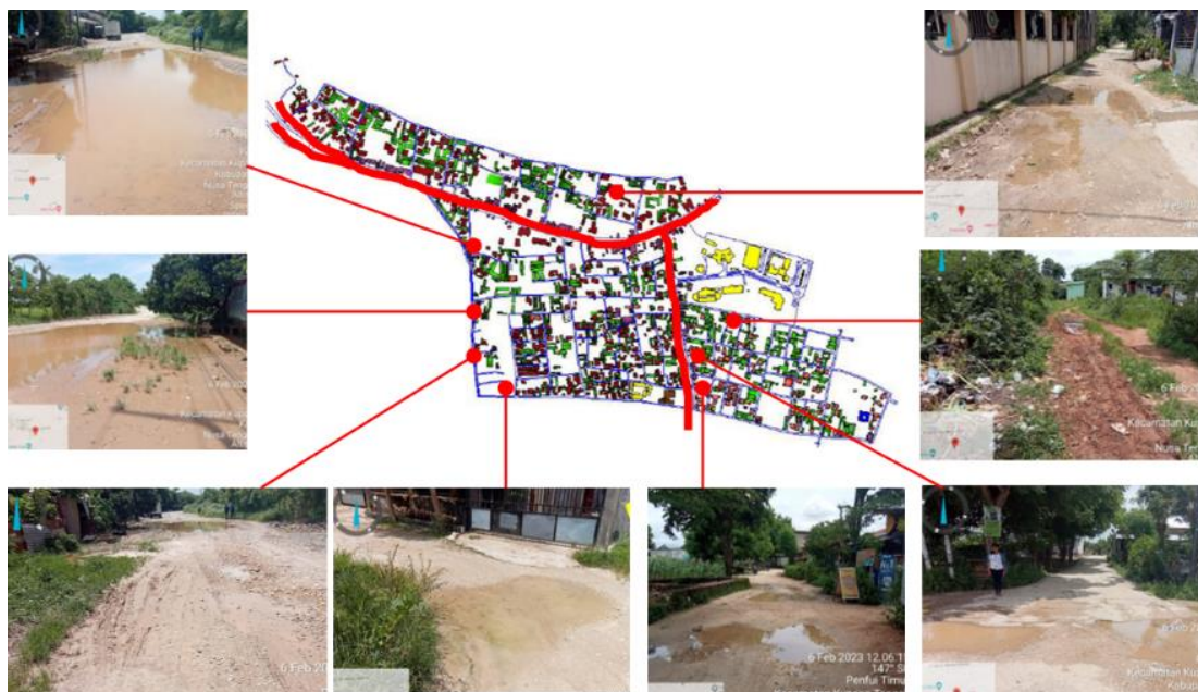
Gambar 6. Titik genangan air dan kondisi jalan di Dusun 1 Penfui Timur
