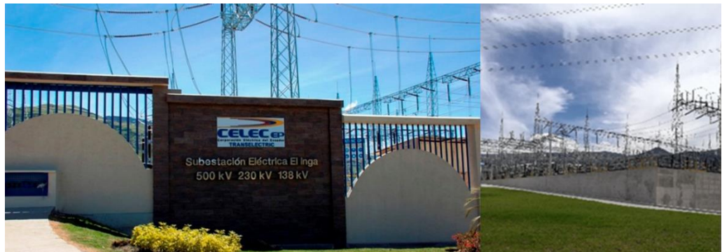
Imagen N.- 10 Subestación Eléctrica El Inga, Comité de Desarrollo Comunitario El Inga Bajo
