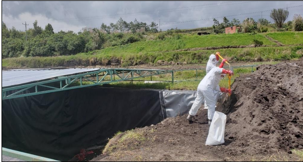
Fotografía N° 28. Cobertura de los Desechos Biopeligrosos
