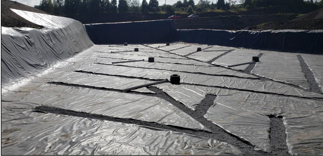
Fotografía N° 20. Sistema de Drenaje e Impermeabilización
