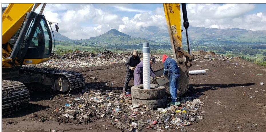
Fotografía N° 39. Chimeneas del Relleno Sanitario Romerillos
