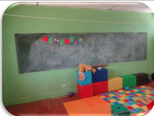
Foto nº 08 pizarras de cemento en mal estado, serán recubierto con pared de drywall
