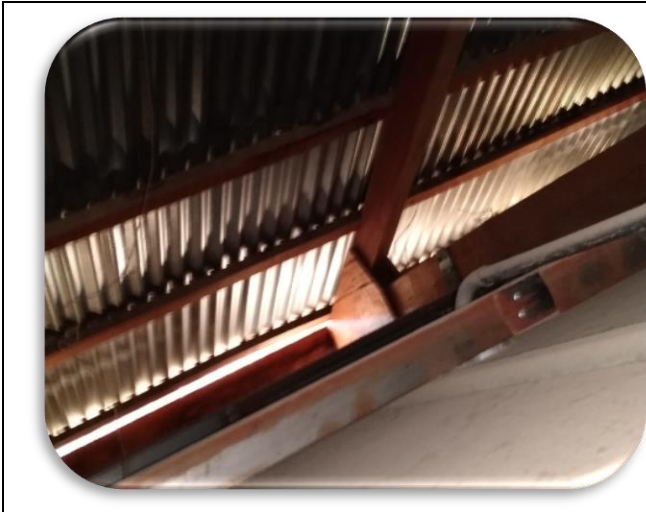
Foto nº 01 interior de estructura de techo a dos aguas (calamina y cuarterones de madera )
