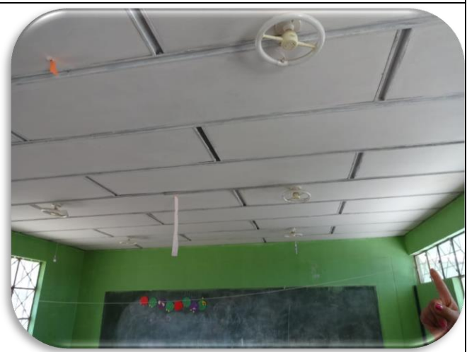
Foto nº 06: techo al interior del ambiente, de baldosa acústica con rieles de metal
