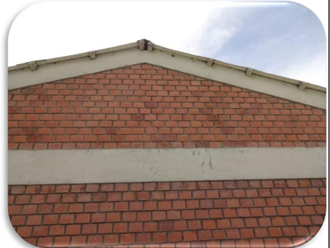
Foto nº 04: exterior del ambiente de estudio, paredes de ladrillo caravista con vigas de amarre
