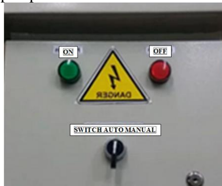
Gambar 4. Panel Kontrol Pompa Tampak Depan
