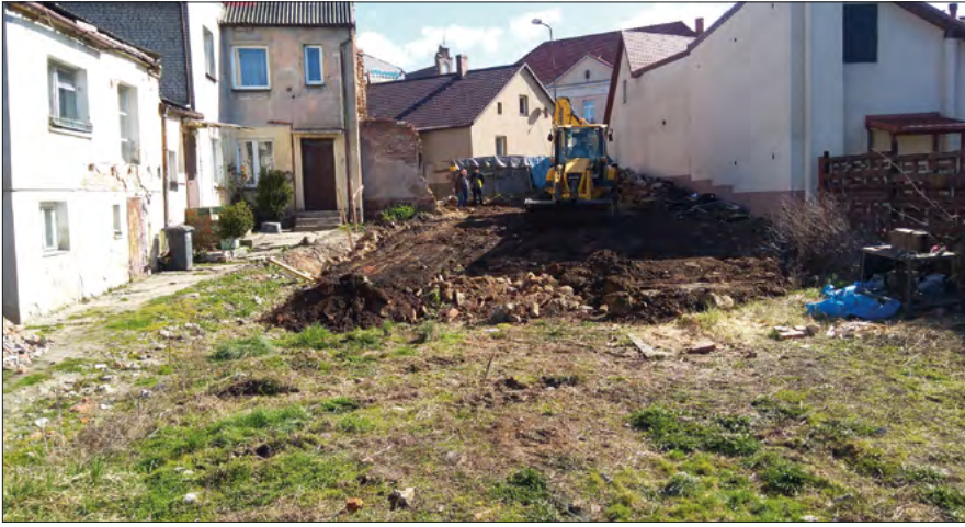
Ryc. 5. Widok ogólny działki I od strony ul. Rzecznej w momencie rozpoczęcia robót ziemnych (fot. P. Banaszak).
