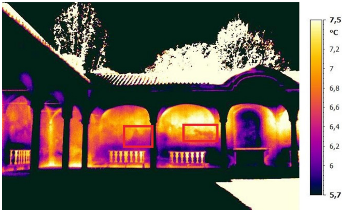
Fig. 1 Termogramma del lato sud, ripresa che include l'angolo sud-est, aprile 2021. I valori misurati dalla termocamera mostrano una zona con temperature minori alla base della parete, inoltre anche le temperature superficiali della pittura muraria nella cornice, campata centrale, presentano valori meno elevati del resto della superficie degli elevati (probabilmente a causa di una differenza di spessore della muratura). Infine, le zone nei riquadri rossi sono quelle in cui si rilevano differenze di temperatura dovute alla presenza di materiali diversi, quali malte di restauro e di manutenzione. Le zone nei riquadri corrispondono anche alla parte maggiormente degradata, a causa dei frequenti cicli di bagnatura e asciugatura, che avvengono in dipendenza dalle condizioni ambientali e per le variazioni di imbibizione.
