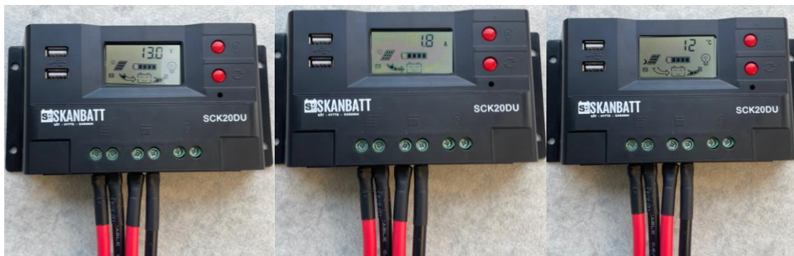
Figur 46. Ladeeffekt fra solcellene til batteriet i direkte sollys 16.11.22
