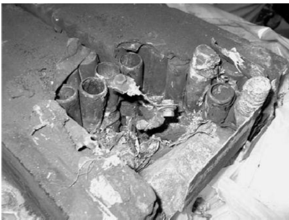
Abb. 24: Batteriebrand und –explosion verursacht durch Thermal Runaway [Beau08, S.9]
