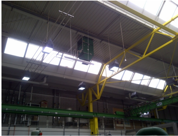
Abbildung 4: Wärmetauscher mit Gebläse
