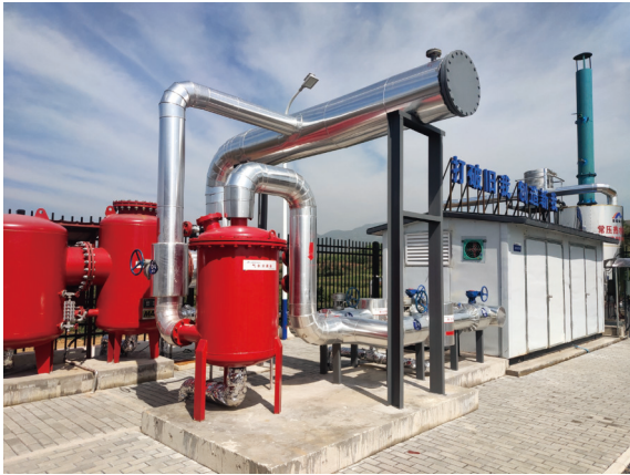
图20 低浓度煤层气直燃制热系统
