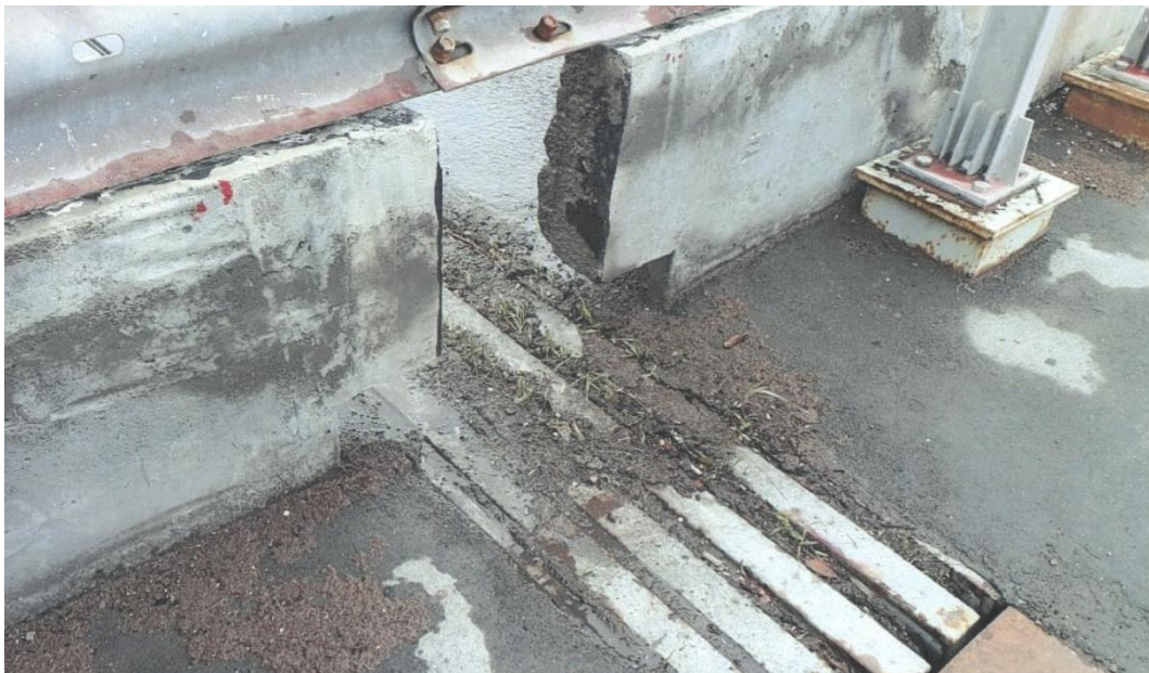
Рис. 3. Нарушение правил содержания деформационного шва моста
