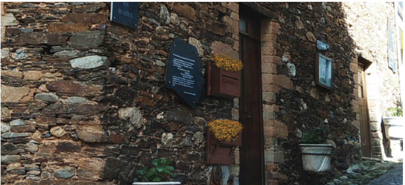
Figura 111 - Exemplo de aplicação de caixas de correio e floreiras de dissimulação de caixas técnicas
