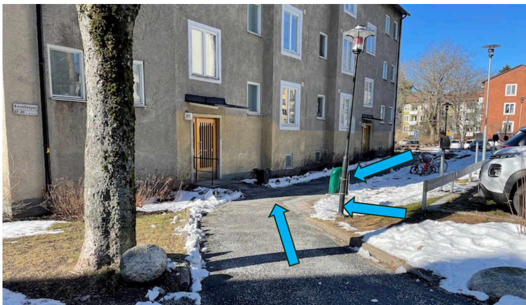
Figur 15. Instängd lågpunkt vid den mindre byggnaden, här finns det risk för att vatten blir stående mot fasaden vid stora regnmängder. Blå pilar visar lutning (Foto: Frida Helander 2023).
