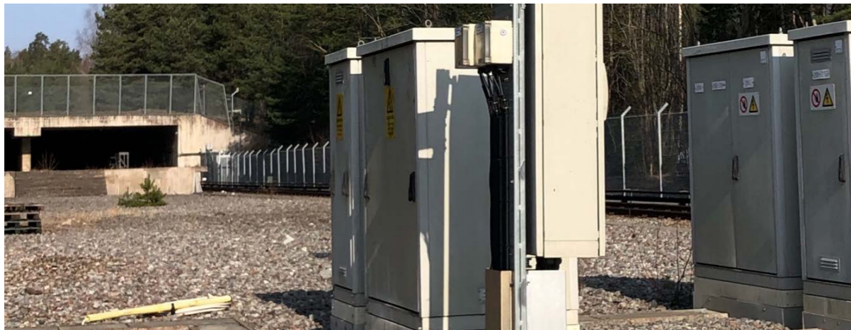
Fig 53. Grusytan med elskåp tillhörande transformatorstationen i förgrunden.
