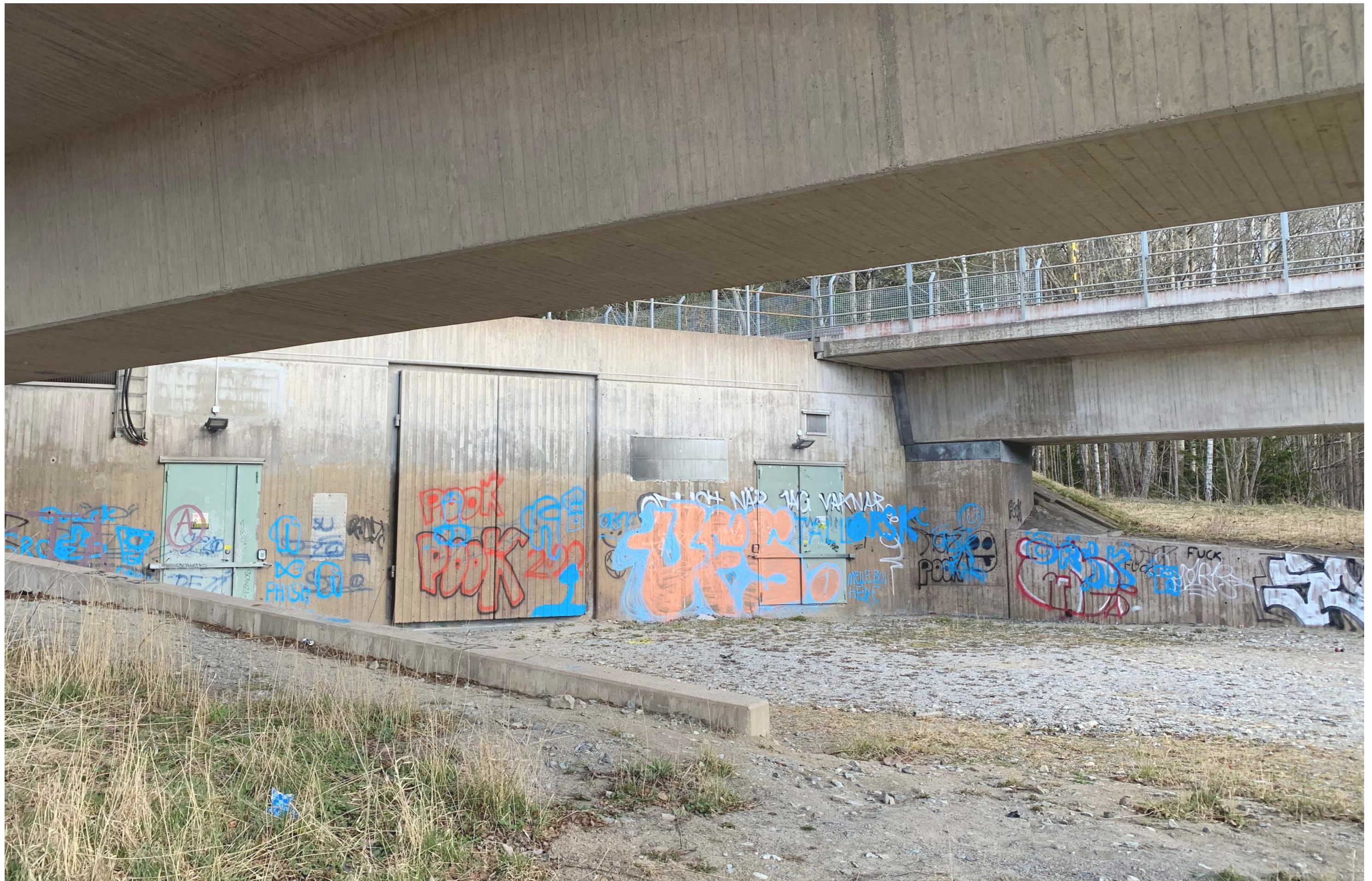
Fig 41. Ingången till transformatorstationen i södra änden av tunnelbanestationen.
