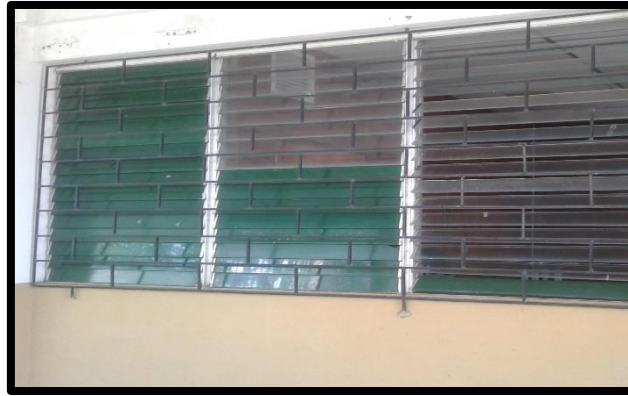
Figura 33: Problema de falta de iluminación por ventanas pintadas.
