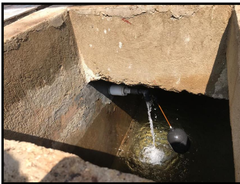
Figura 3. 29 “La cisterna se abastece por medio del servicio de agua potable de ANDA”.
