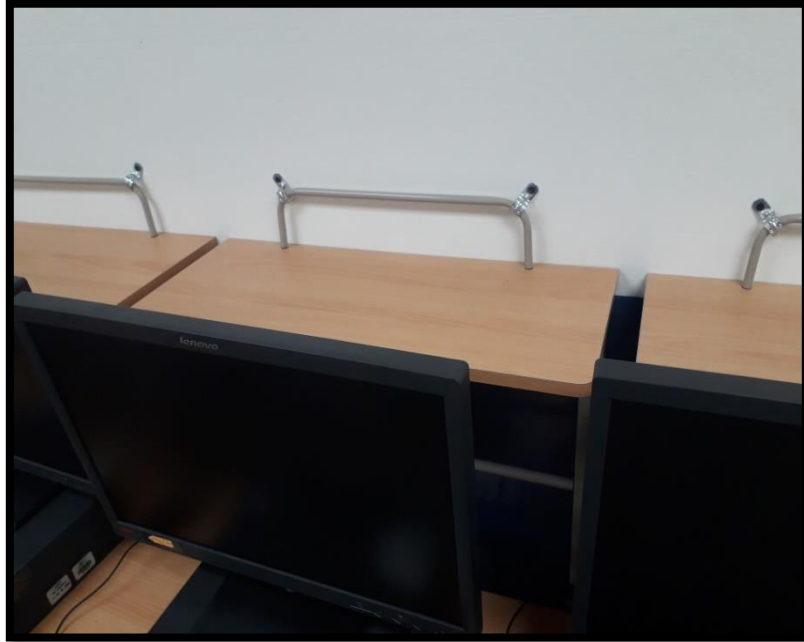
Figura 3. 35 “Computadoras cuentan con un sistema de anclaje el cual restringe su movilidad durante un sismo”.
