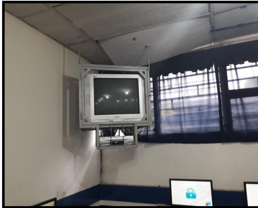
Figura 3. 36 “Sistema audiovisual anclado con cables de acero lo cual reduce la caída sobre algún usuario del centro de computación”.
