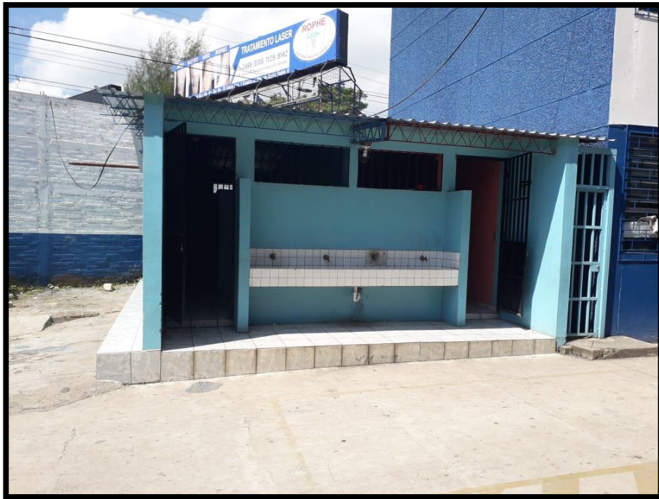
Figura 3. 60 “Servicios sanitarios de educación básica sin acceso para personas con discapacidad”.
