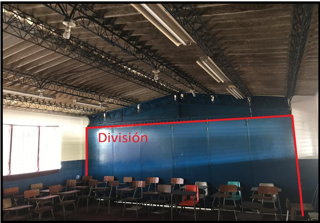
Figura 3. 38 “Condición y seguridad de las divisiones internas de las aulas”.
