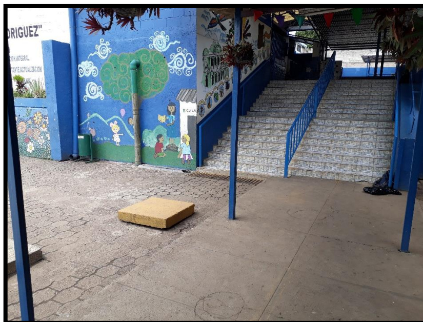
Figura 3. 56 “Área de circulación hacia el auditorium sin rampas”.
