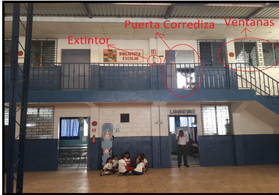
Figura 3. 50 “La entrada de la biblioteca incumple el criterio de ancho del ISCE”.
