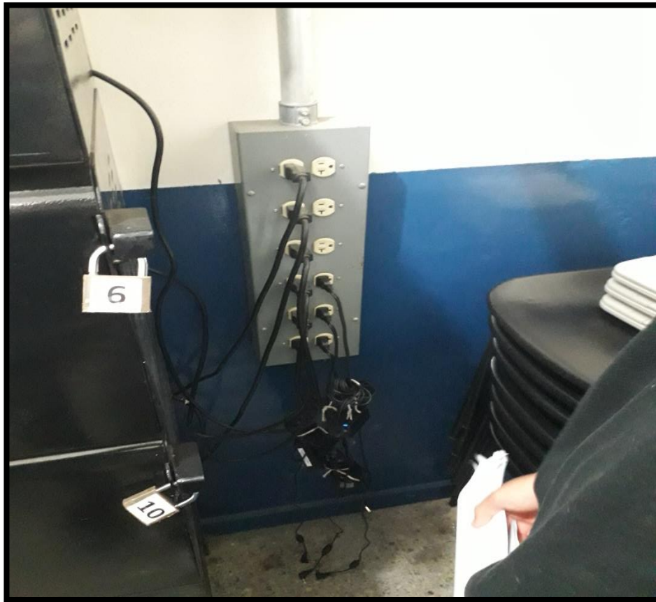
Figura 3. 21 “Nivel de tomacorrientes instalado a un nivel adecuado ante la posibilidad de una inundación”.
