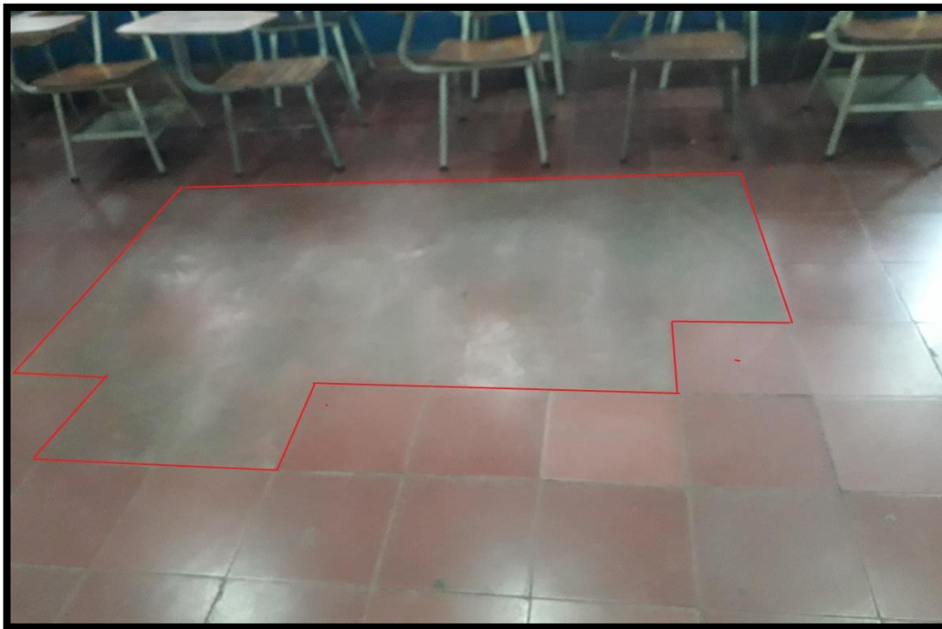
Figura 3. 40 “Estado actual del piso de un aula del Edificio de Educación Media”.
