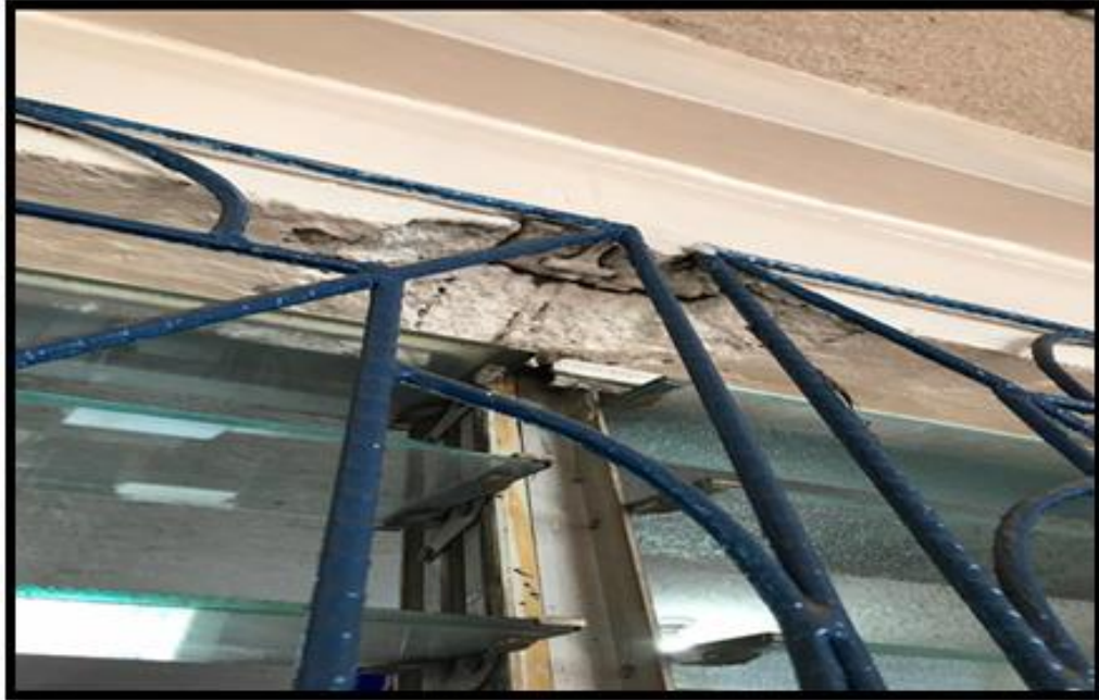
Figura 3. 39 “Ventanas de aulas del Edificio de Educación Media con defensas metálicas dañadas”.
