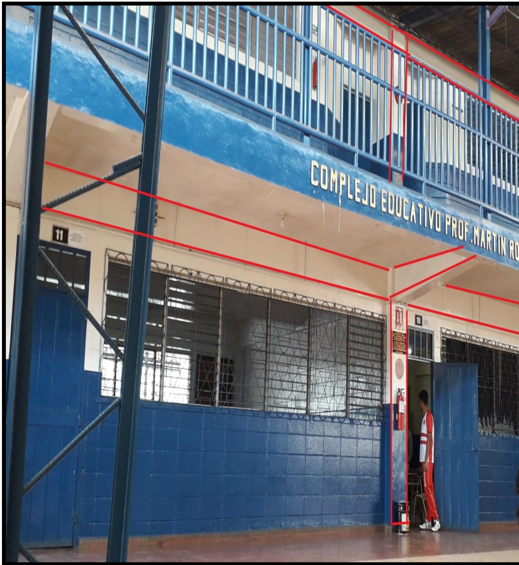
Figura 3. 12 “Estado de las columnas y vigas en perfectas condiciones, no presentan grietas”.
