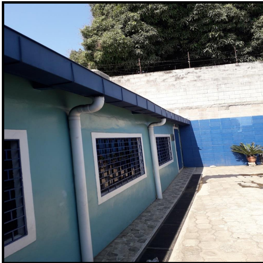
Figura 3.33 “Sistema de drenaje pluvial en perfectas condiciones”.
