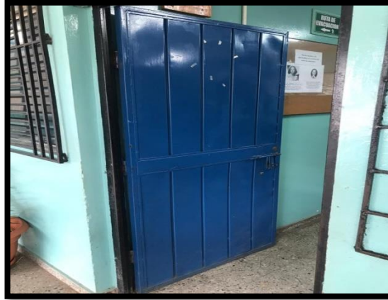
Figura 3. 44 “Estado de las puertas del sector administrativo”.
