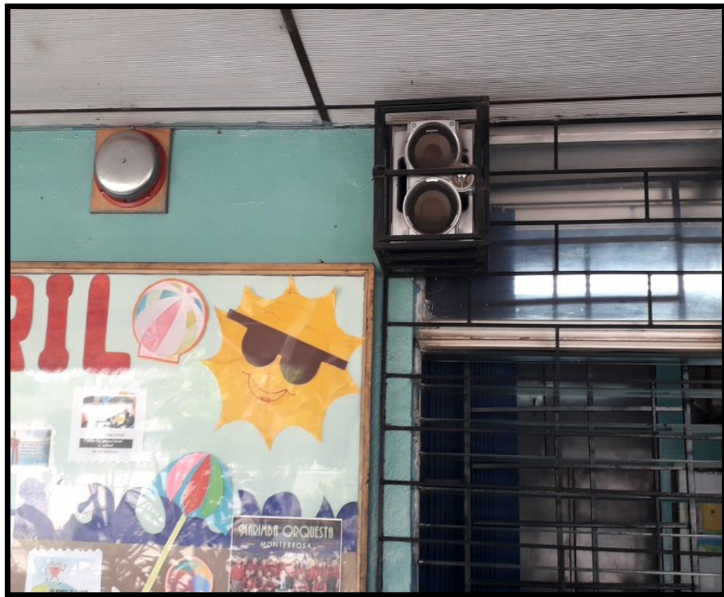
Figura 3. 26 “Equipo de telecomunicaciones interno del centro educativo el cual se encuentra operando perfectamente”.
