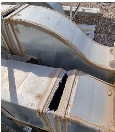
Figura 6. Desperfectos en las uniones de los conductos.
