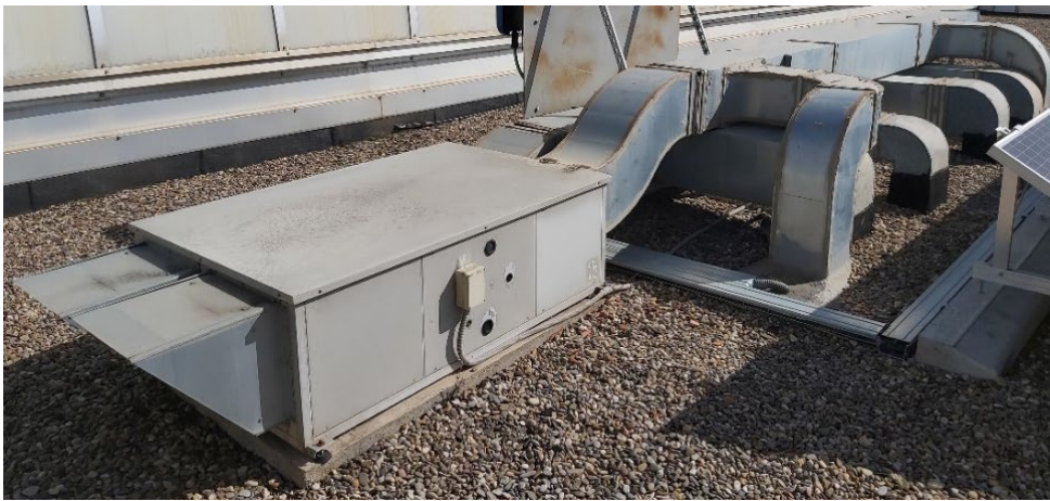
Figura 4. Recuperador Novovent Recunovo 190. Cubierta Torres Quevedo. Imagen propia.
