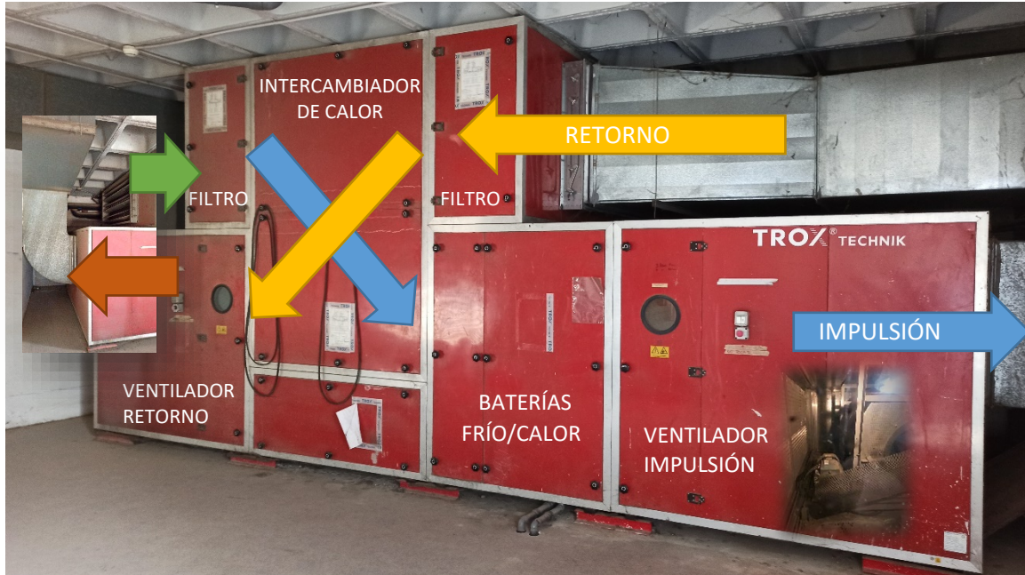
Figura 7. Climatizador o UTA de las aulas. Elaboración propia.
