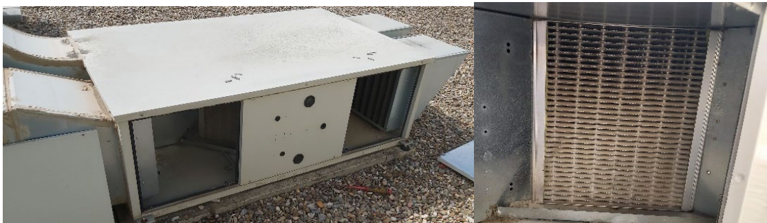
Figura 5. Recuperador con las tapas desmontadas. Cubierta Torres Quevedo. Imagen propia.
