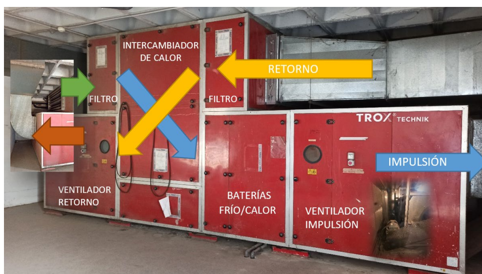
Figura 32. Climatizador o UTA de las aulas. Elaboración propia.
