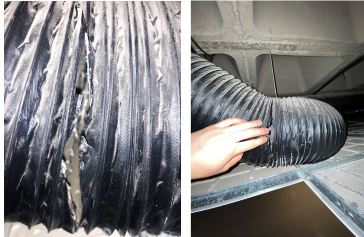
Figura 6. Estado de la fisura en el conducto flexible de aporte de aire de ventilación, antes de su reparación.
