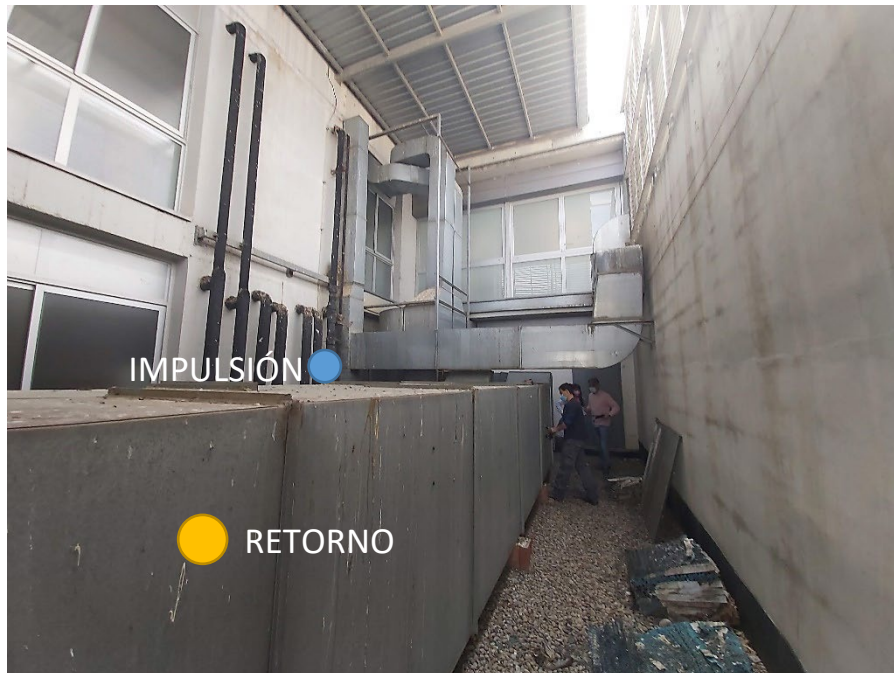
Figura 8. Conductos de impulsión y retorno a la salida del climatizador. Puntos de medida. Al fondo, reparto a plantas.
