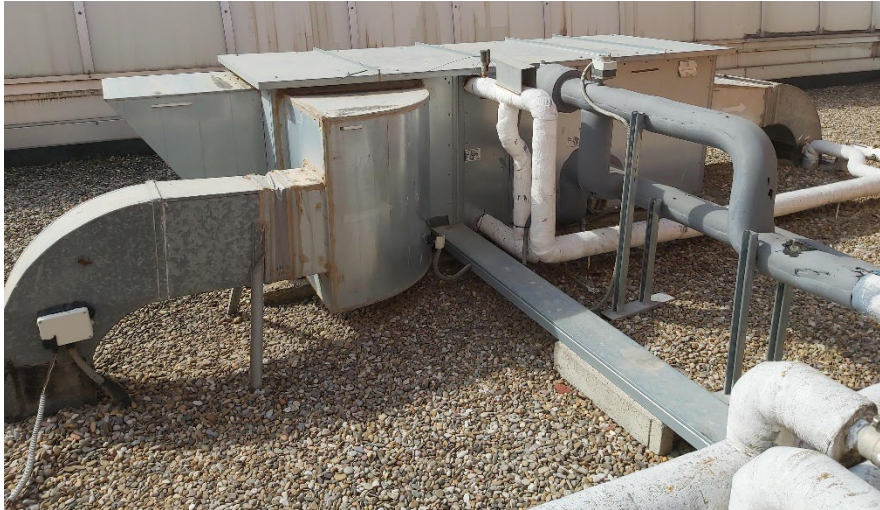
Figura 11. Climatizador antiguo en cubierta. Imagen propia.
