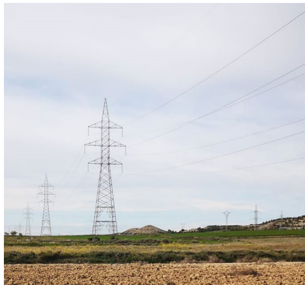
Figura 15: Línea aérea de 220kV Duplex, subestación de Peñaflo, 2022.
