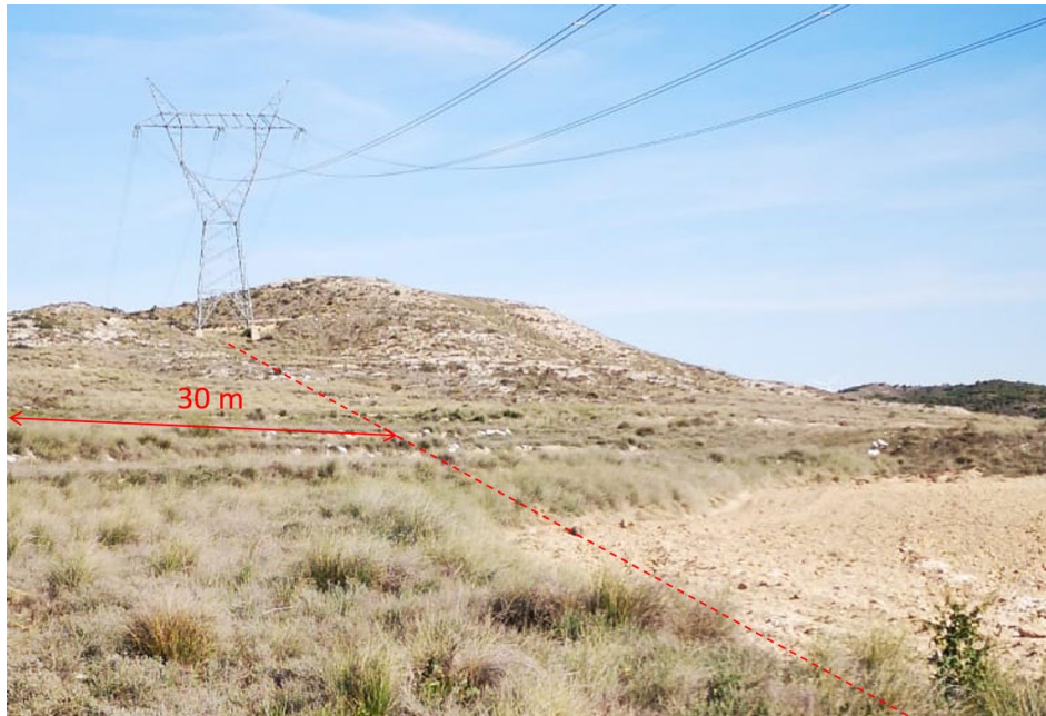
Figura 17: Línea aérea de 400kV y procedimiento de medida, subestación de Peñaflor, 2022.
