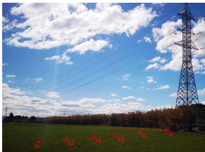
Figura 11: Línea de 45kV en Zaragoza, Procedimiento de medida, 2022.
