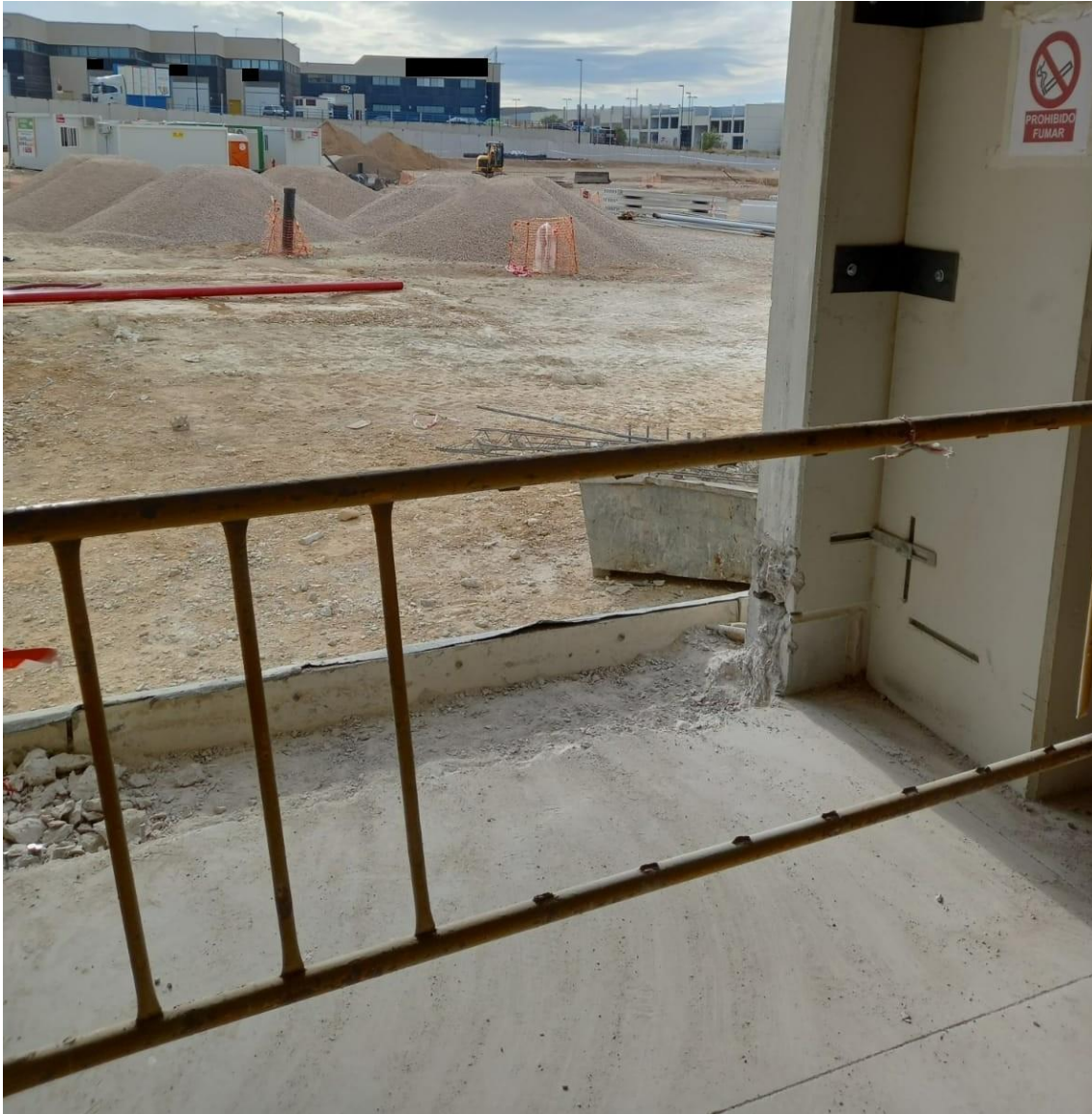
Foto 4: Durante una visita obra, me encontré con esta vaya la cual tenía barrotes cortados y no cumplía con su finalidad de impedir el paso de los trabajadores al exterior en una zona de paso de vehículos, y evidentemente no estaba en buenas condiciones.
