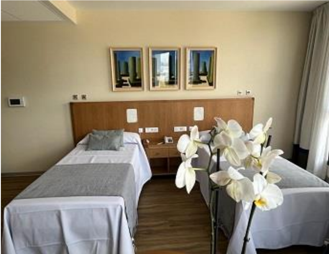
Foto 10: instalación del sistema paciente enfermera en las habitaciones.
