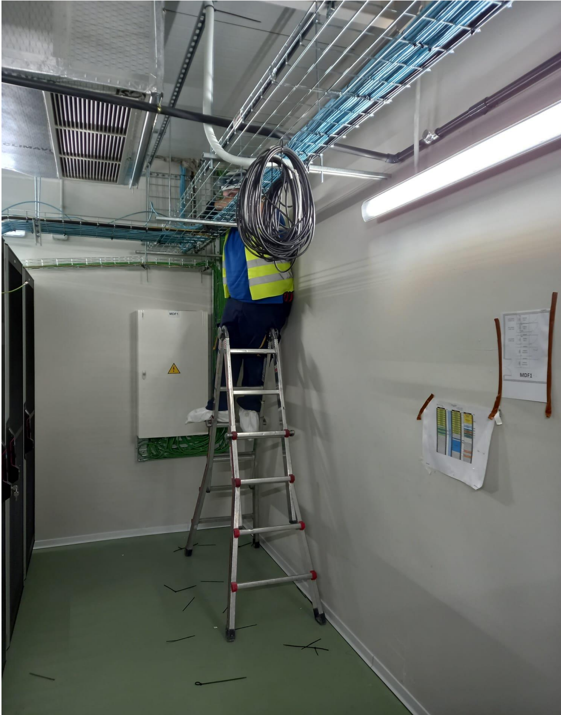
Foto 7: Lo que más me llamó la atención de este operario es como estaba apoyado en la escalera, poniendo en peligro la estabilidad de esta y originando una posible caída en altura del trabajador. Además de haber trozos de bridas en el suelo.
