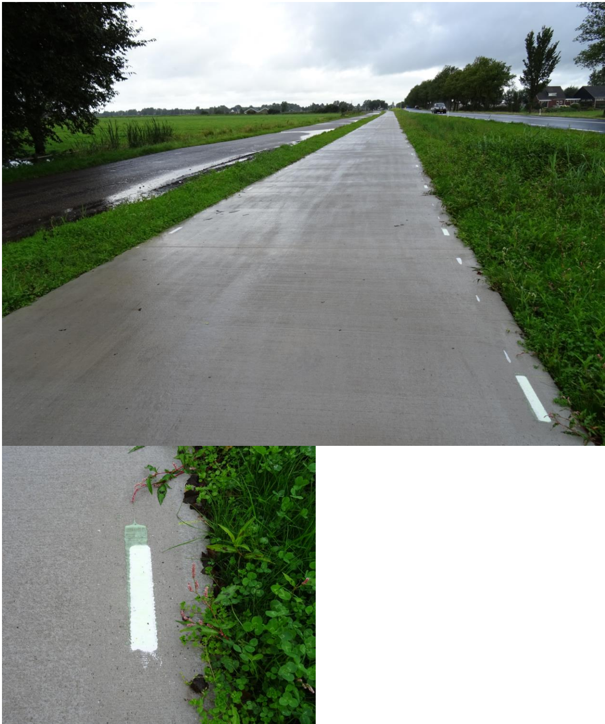
Figuur 4. Glowmarkering, onderbroken
