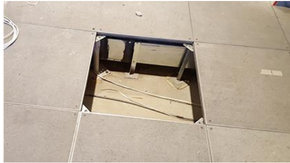
Figure 1.13. Système mécanique caché par un plancher surélevé [47].
