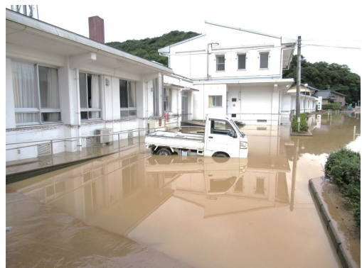
図3 施設Cの被害状況(施設提供)窓枠の下に黒色の明瞭な浸水痕跡あり
