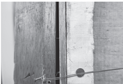
図16 裏面・入れ子が湾曲し隙間ができている
