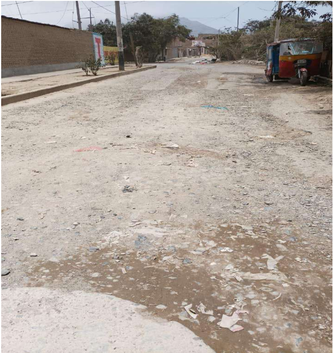
Vista 6. Deformaciones y pérdidas de capas estructurales.
