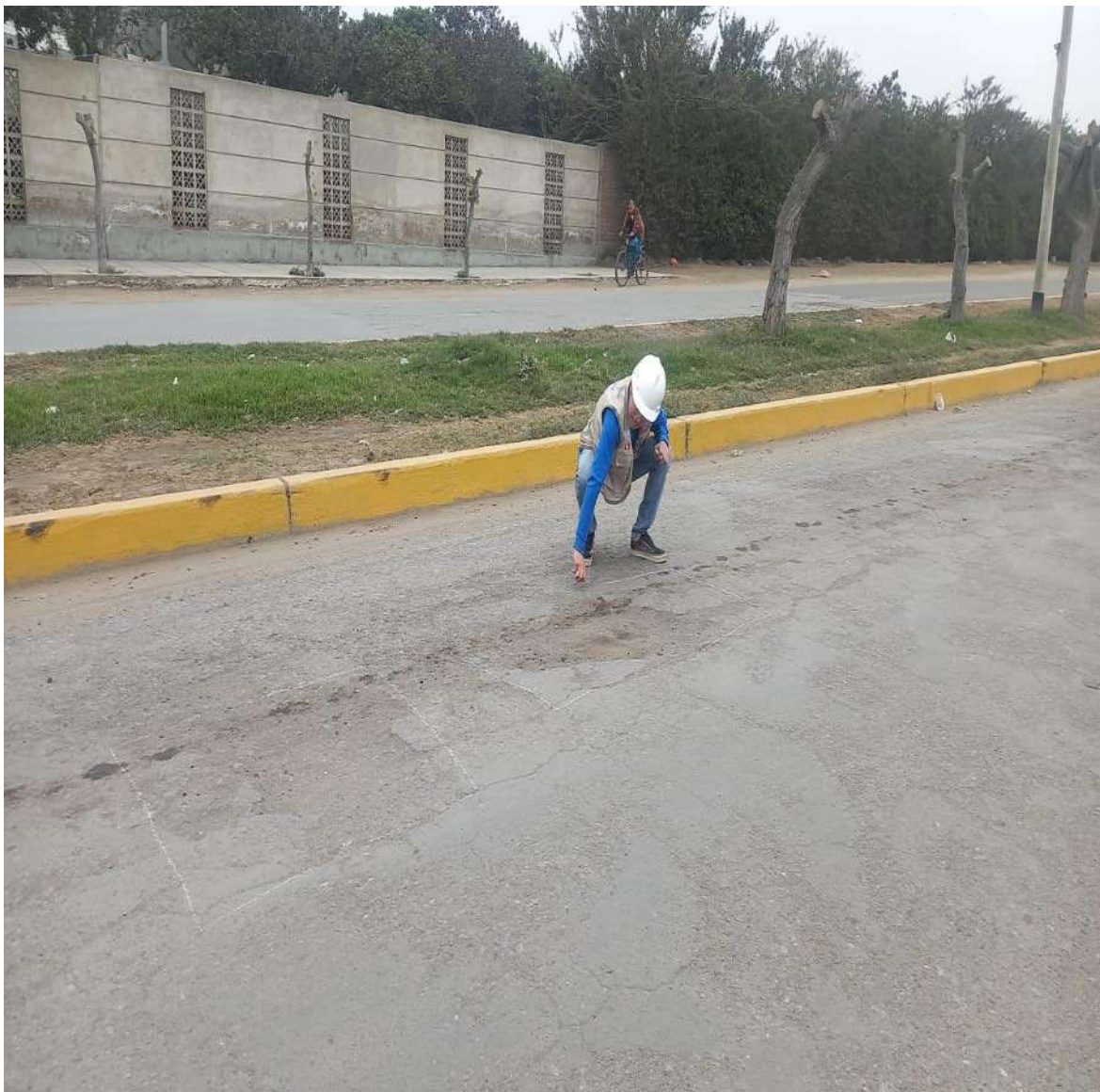
Vista 4. Grietas de borde.
