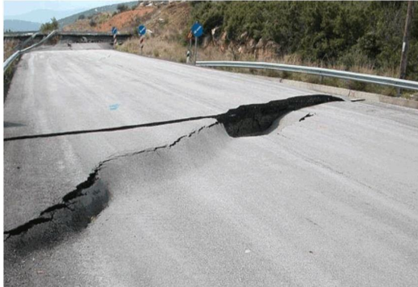
Figura 2. Efectos de un suelo expansivo
