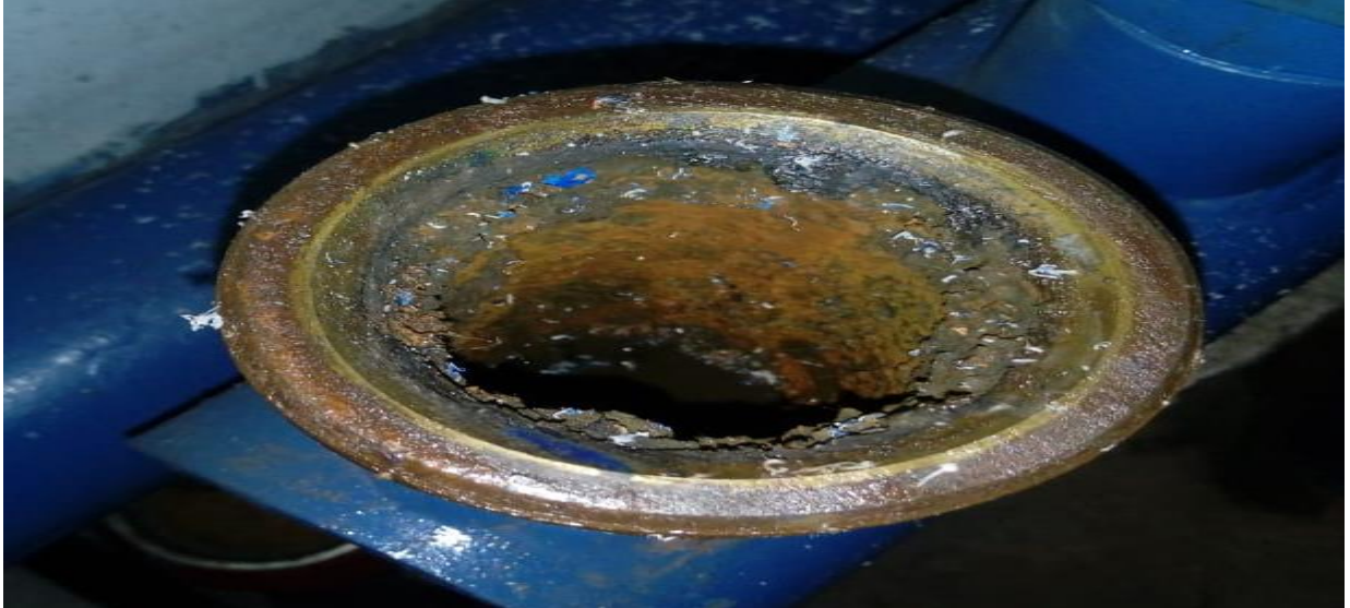
Válvulas de regulación existentes, no cierran ni apertura están obstruidas.
